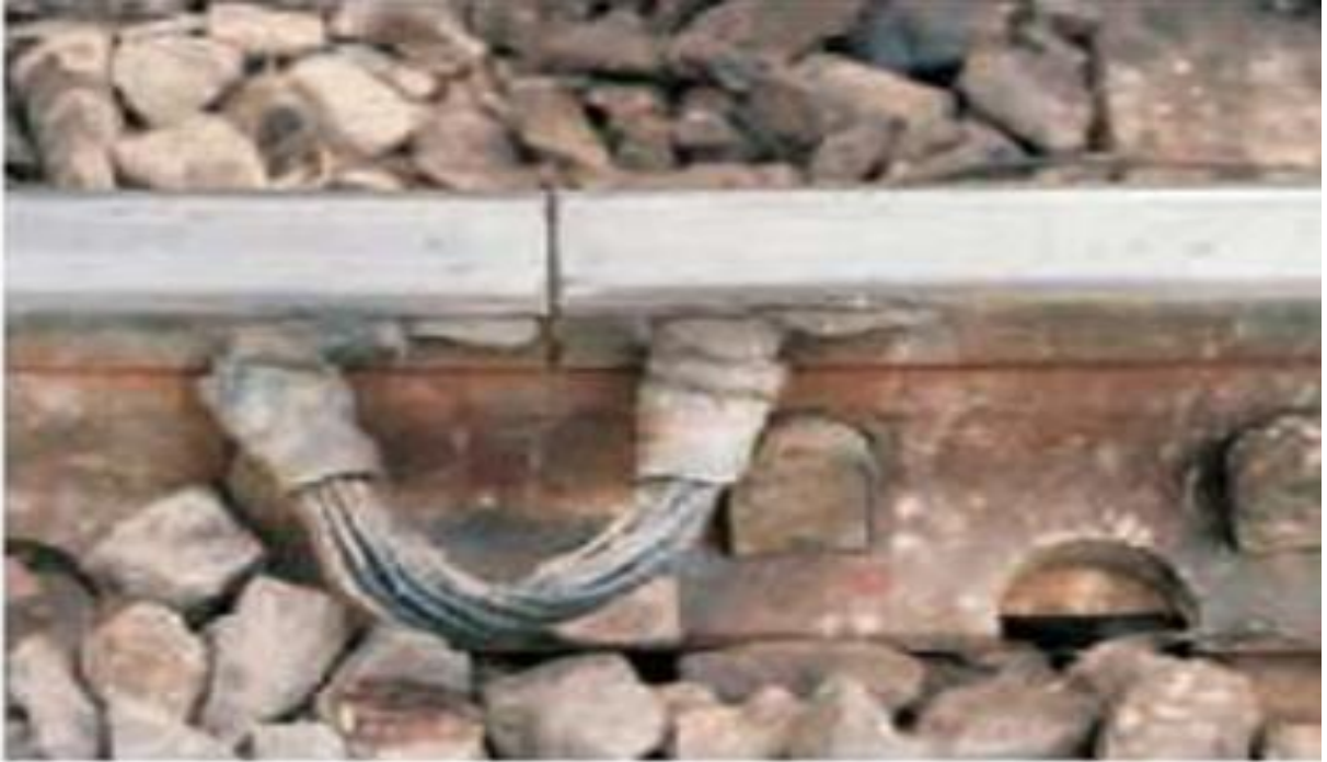
▲ Junta de dilatación en rieles de ferrocarril.
